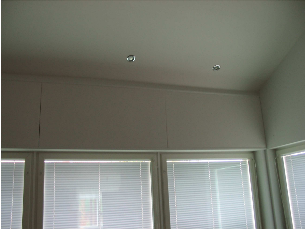
Kuva 7.5 Kohteessa 3 olohuoneen seinään asennettuja akustiikkalevyjä.
