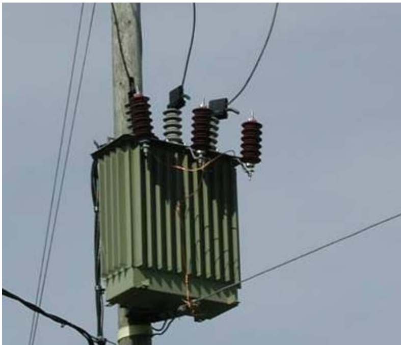
Kuva 7.1. Jakelumuuntaja ja puoliventtiilisuojat [Hei 06].
