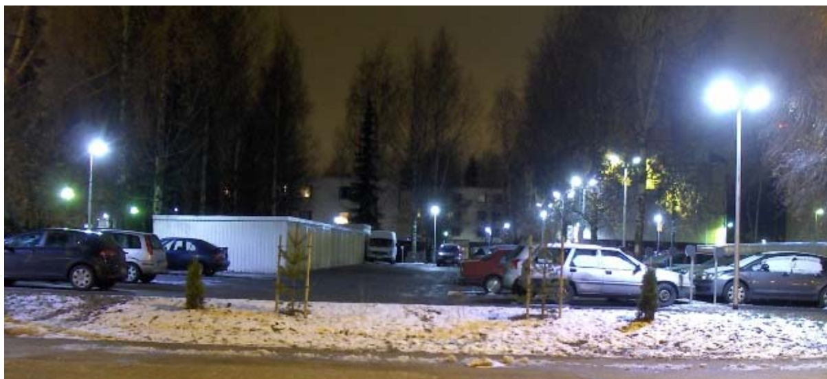
Kuva 9 Ratavallintie, Helsinki. 41 W LED-ulkovalaisin asuntoalueen valaistuksessa
