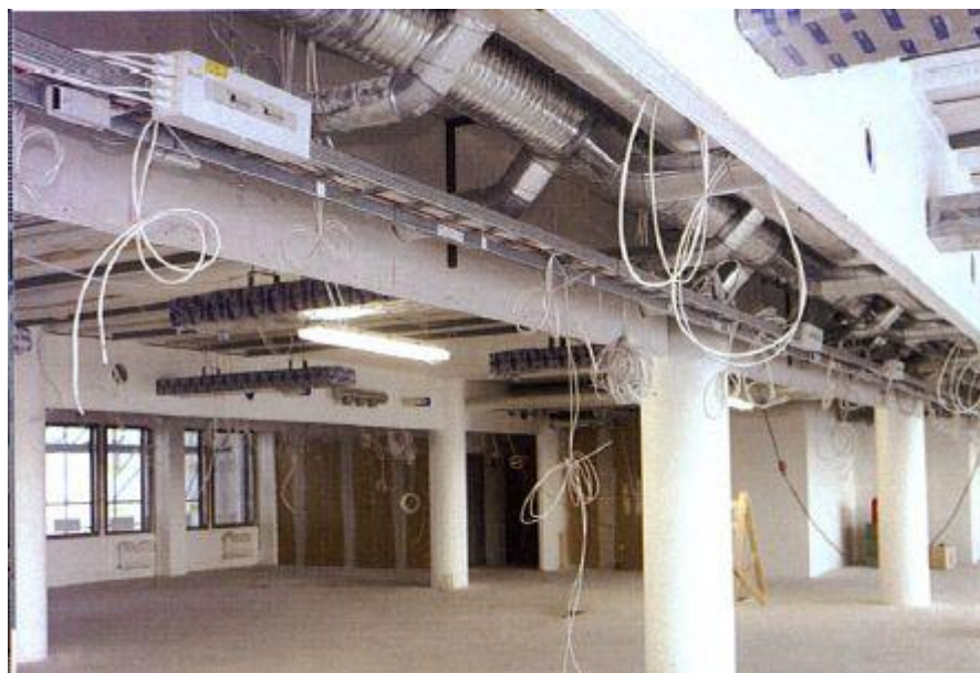
Kuva 3. Virtakiskojakelu sekä EnstoNet-kaapelointia (Nousiainen 2009).
