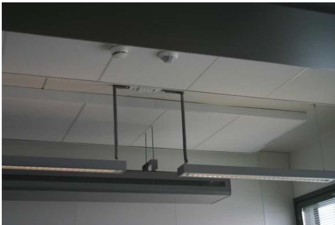
Kuva 17. Toimistohuoneen valaisimet sekä paloilmaisin ja läsnäolosensori.
