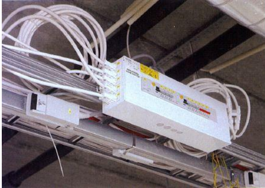
Kuva 2. Jakelukotelo kaapelihyllylle asennettuna. (Nousiainen 2009).
