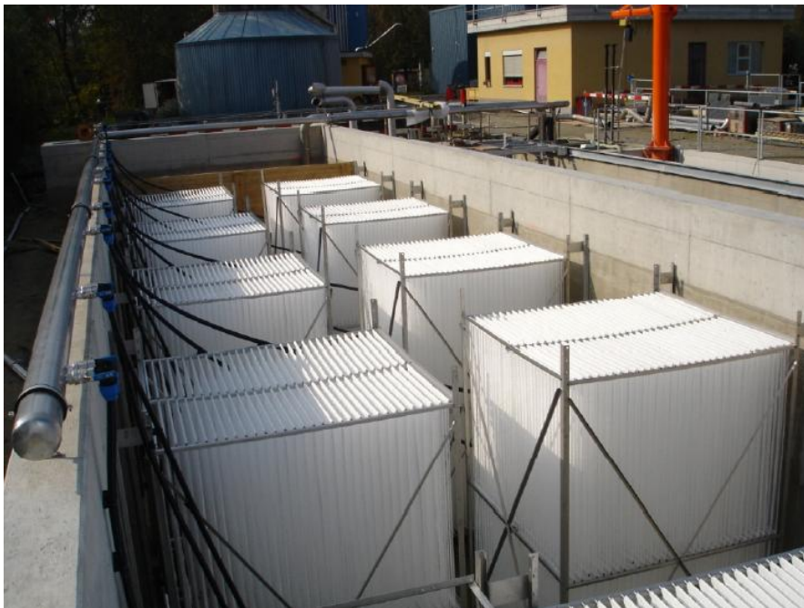
Kuva 10. Biotextil Cleartec –yksiköitä ilmastusaltaassa
