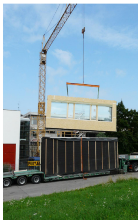
Kuva 6 TES-menetelmä mahdollistaa asennuksen ilman rakennustelineitä. Tässä kohteessa julkisivuverhous tehtiin paikan päällä. [Lähde: TKK, TES loppuraportti, s. 39]
